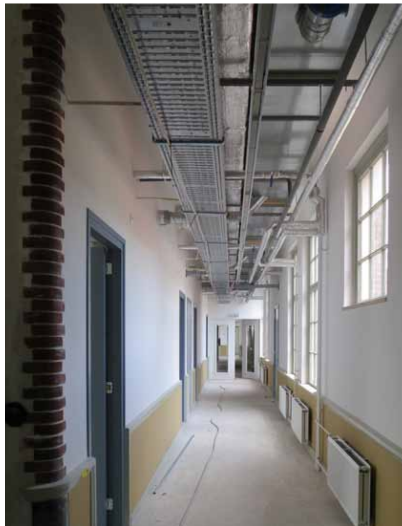
^ Let op leidingwerk door uw monument als gevolg van bijvoorbeeld een luchtbehandelingsinstallatie (Kazernes, Ede).
