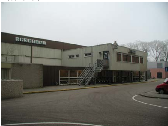
De sporthal ziet er verouderd uit door de sobere kleurstelling en materiaalgebruik.
